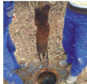
BEV-Kompaktschacht voller Wurzeln
